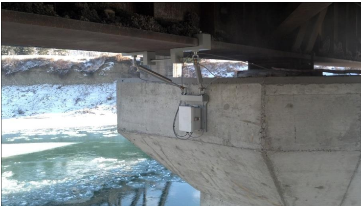
Gambar 2.7 Alat LVDT pada Jembatan
