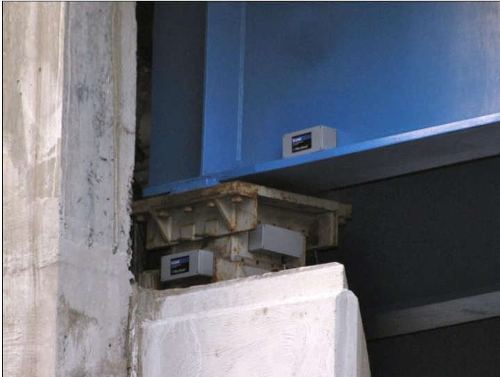
Gambar 2.6 Alat Accelerometer pada Jembatan
